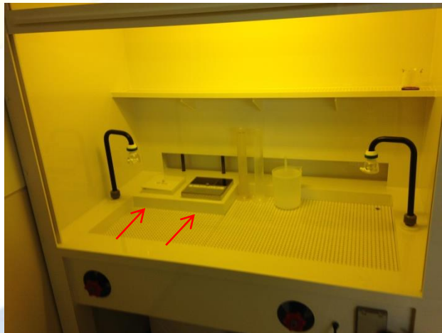
廃液回収用漏斗設置(有機用、無機用)
