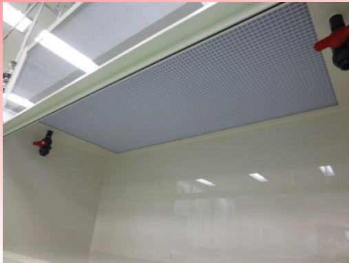
天井からの水道等配管
