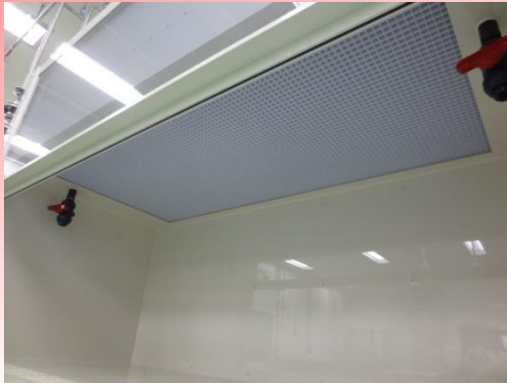
天井からの水道等配管
