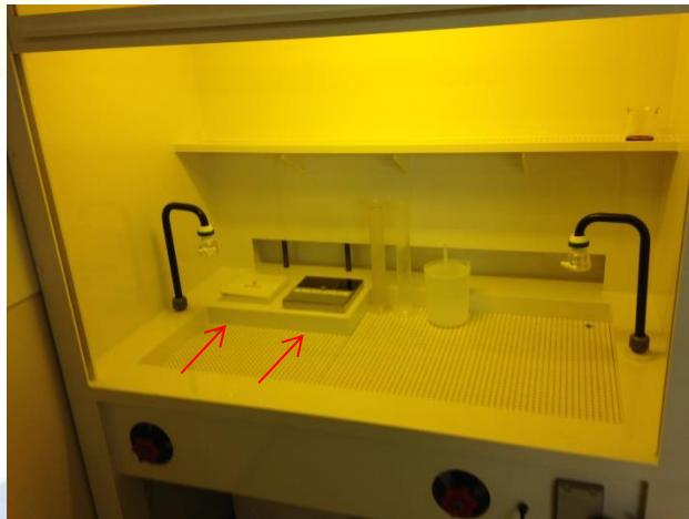
廃液回収用漏斗設置(有機用、無機用)
