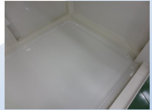
設備内漏水センサー設置
